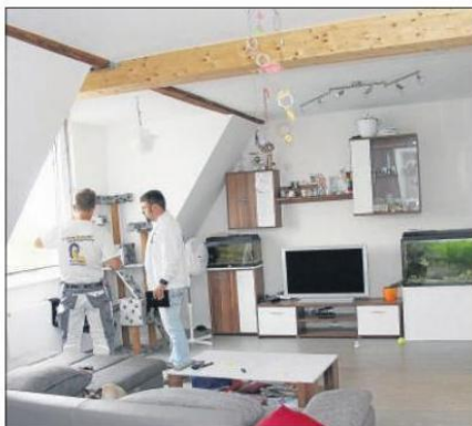
Alt und neu kombiniert: Im Wohnzimmer der Dachgeschosswohnung ist ein neuer Trägerbalken eingezogen worden.
